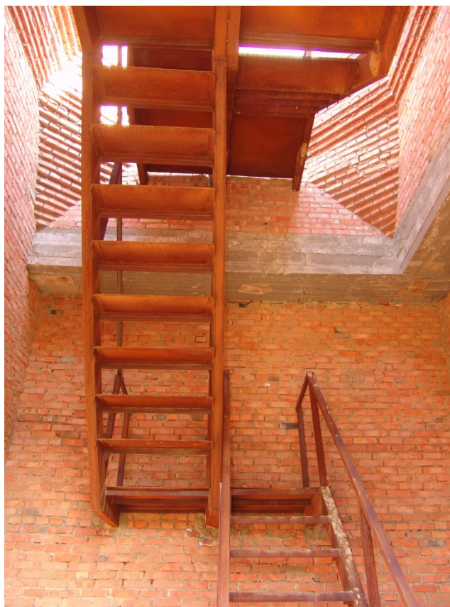
Фото 5.7 – Лестница в осях 2-3. Отсутствует огнезащитная и антикоррозийная обработка. Поверхностная коррозия металлических конструкций
