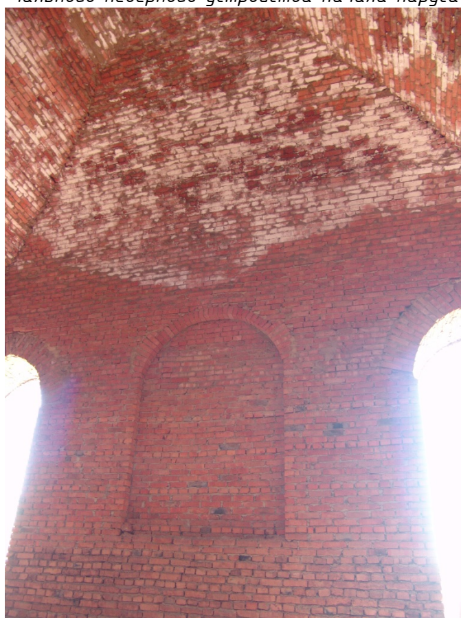
Фото 5.6 – Кирпичное перекрытие в осях В-Д/5-7. Высолы по кирпичной кладке перекрытия
