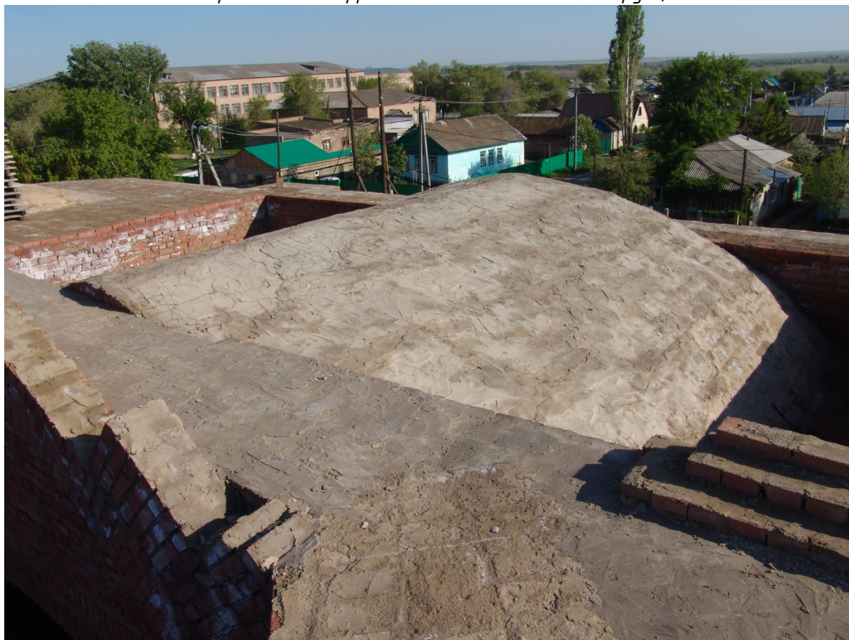
Фото 5.8 – Перекрытие в осях 3-5/А-В. Нарушена проектная геометрия перекрытия
